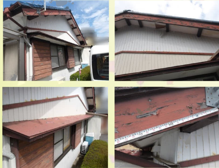
塗膜が劣化して所々、剥がれている状態でした。
