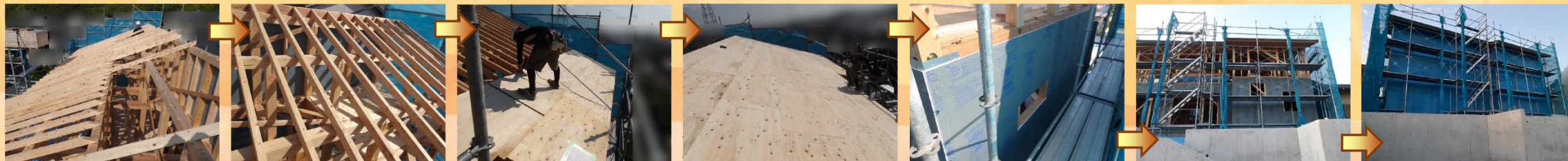
屋根垂木を取り付け、屋根の下地となる野地板を一枚ずつ貼っていきます。
