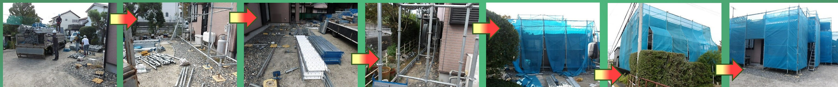
足場を設置します。鋼管等が運び込まれ、職人さん達が手際よく組み上げていきます。
