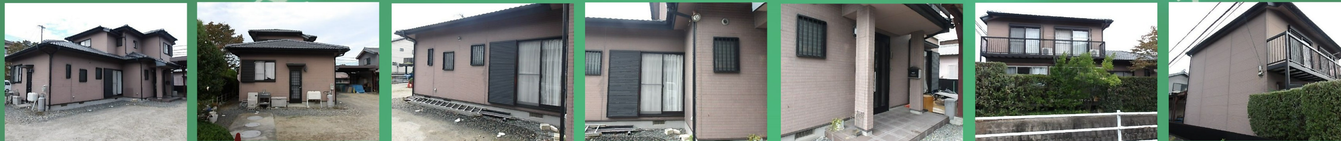
外壁全体がくすんでしまい、コーキングの劣化も進んでしまっている状態でした。
