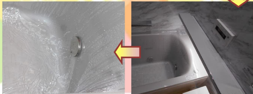
試運転を行い、不具合がないか確認します。
