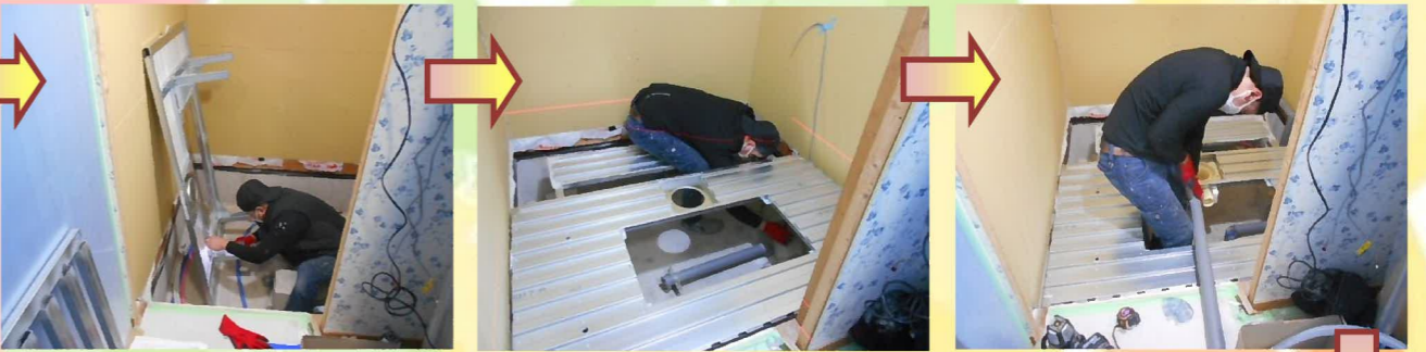
床材から組み立て、床の高さが決まったら排水管を接続します。
