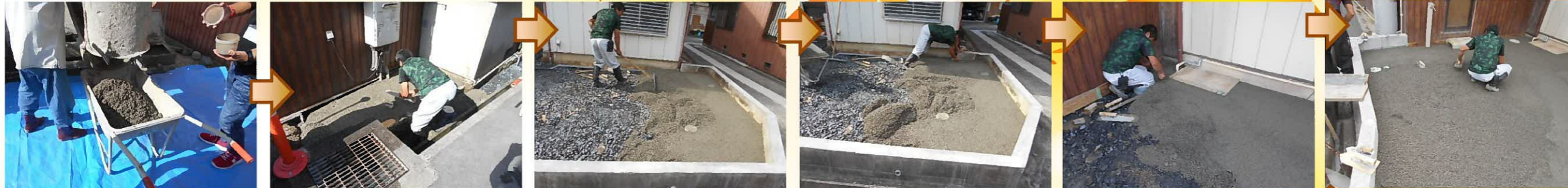
透水性コンクリートが運び込まれ、犬走り部分から打設していきます。
