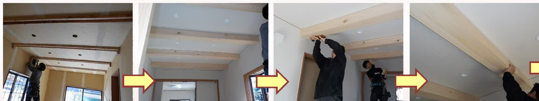
クロス工事の前にリビングの化粧梁の下地材を取り付けます。 クロス工事完了後、化粧梁を仕上げしていきます。カンナやサンドペーパーを使って表面を整えていきます。
