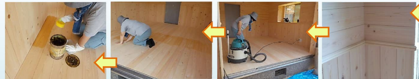
床の掃除を行い、ワックスを塗布していきます。使用しているワックスは天然素材の蜜ロウワックスです。
