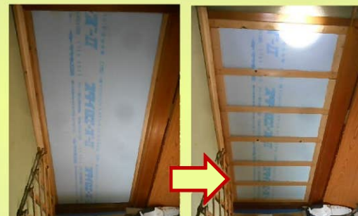
開口部だった部分に断熱材を 充填し、木棧を取り付けて いきます。
