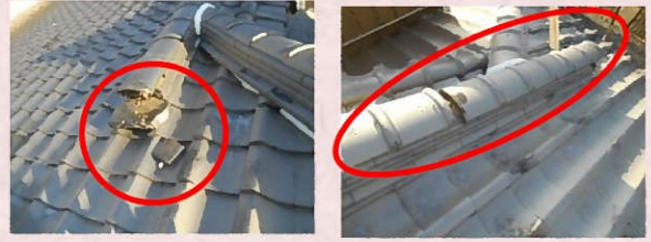
【南面1階】 鬼瓦が外れ、下り棟のし瓦がずれていました。
