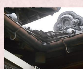
【南面1階西側&東側】 割れてしまっていた軒樋コーナー投げ板を路り替えました。
