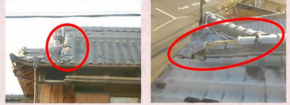
【北面2階】 鬼瓦が外れ、下り棟のし瓦がずれていました。
