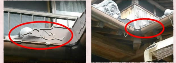
【南面1階西側&東側】 軒樋コーナー投げ板が割れてしまっています。
