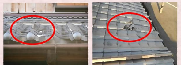
【北面1階】 軒万十瓦と棧瓦が割れてしまっています。
