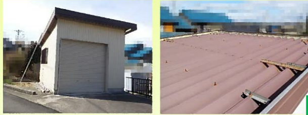
屋根部分は塗装が剥げ、錆が出ていました。
