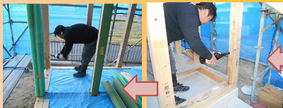
一日の最後には施主様ご家族に建前が無事済んだことをご報告させていただき、建物の四隅と大黒柱にお酒をまいてお清めをさせていただきました(^_^)
