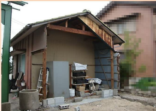
小屋全体に傷みが進んでいる状態でした。
