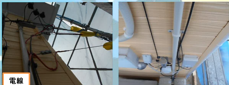
室外機空調カバー& 縦樋
