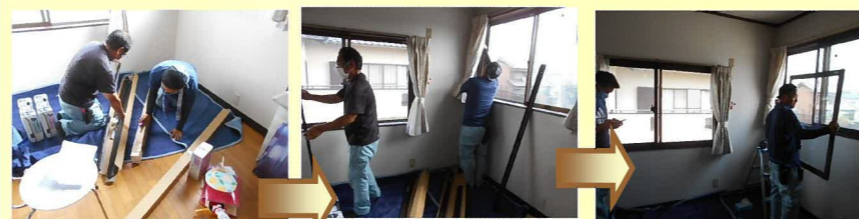
3ヶ所の窓に内窓を設置します。部材が運び込まれ、職人さん達が手際よく手際よく取り付けしていきます。
