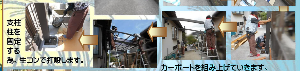
支柱を立てる位置のコンクリートを掘り、穴を掘っていきます。
