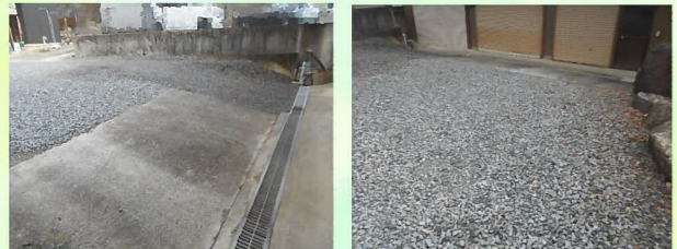
既存の土間は残して透水性コンクリートでスロープを仕上げます。
