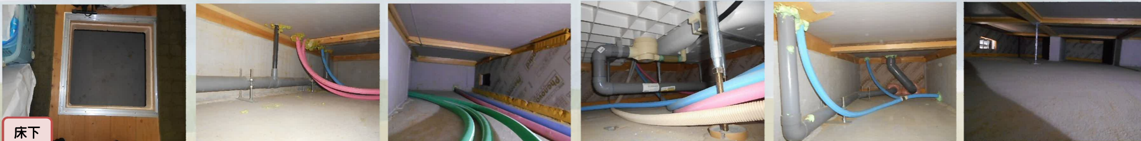
点検口から床下にもぐります。給排水管から水漏れが起きていないかなど、床下の状態を確認します。
