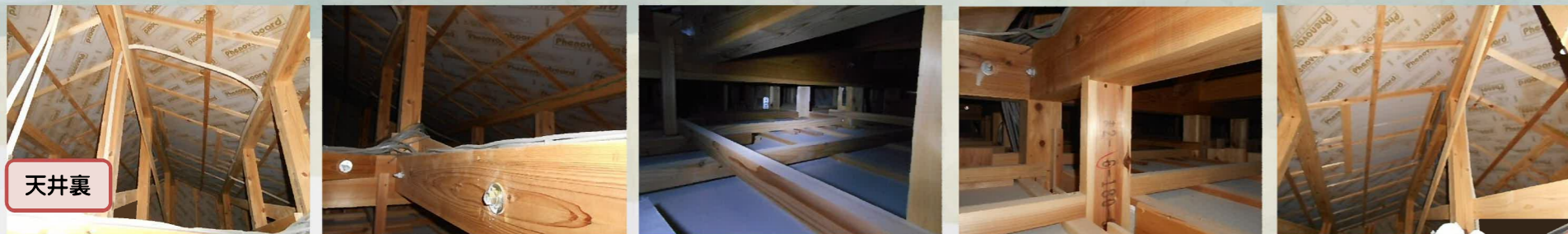
点検口から天井裏に上り、配線やホルトの状態を確認し、雨漏りが起きていないかなど確認します。
